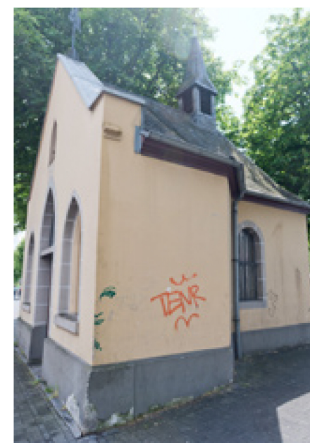
Die Rochuskapelle befindet sich heute wieder in einem schlechten äußeren Zustand
